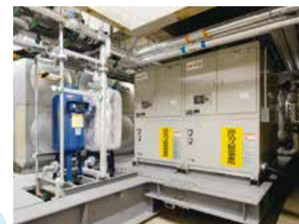
湯野浜温泉街の中心部ある 熱交換システムの集中給湯機械室
