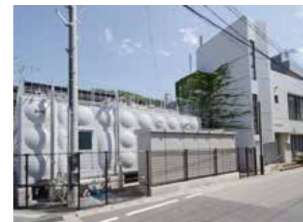
温泉未利用熱を活用した集中給湯設備
