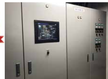
集中給湯動力盤
